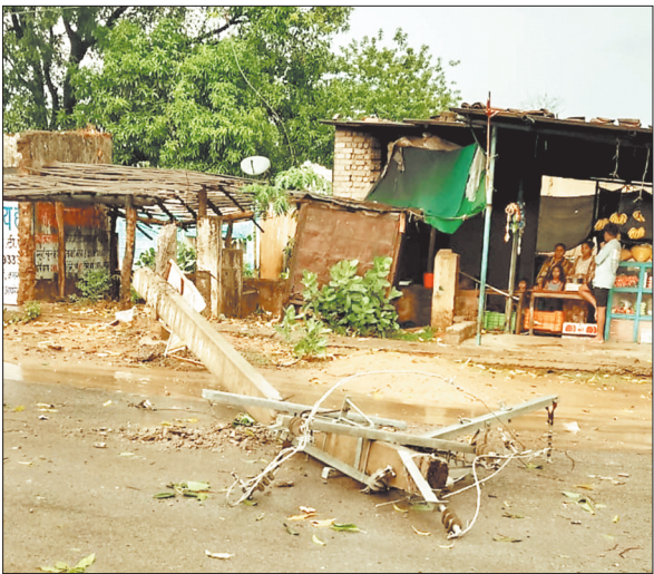
कुदमुरा में क्षतिग्रस्त बिजली का खंभा।
